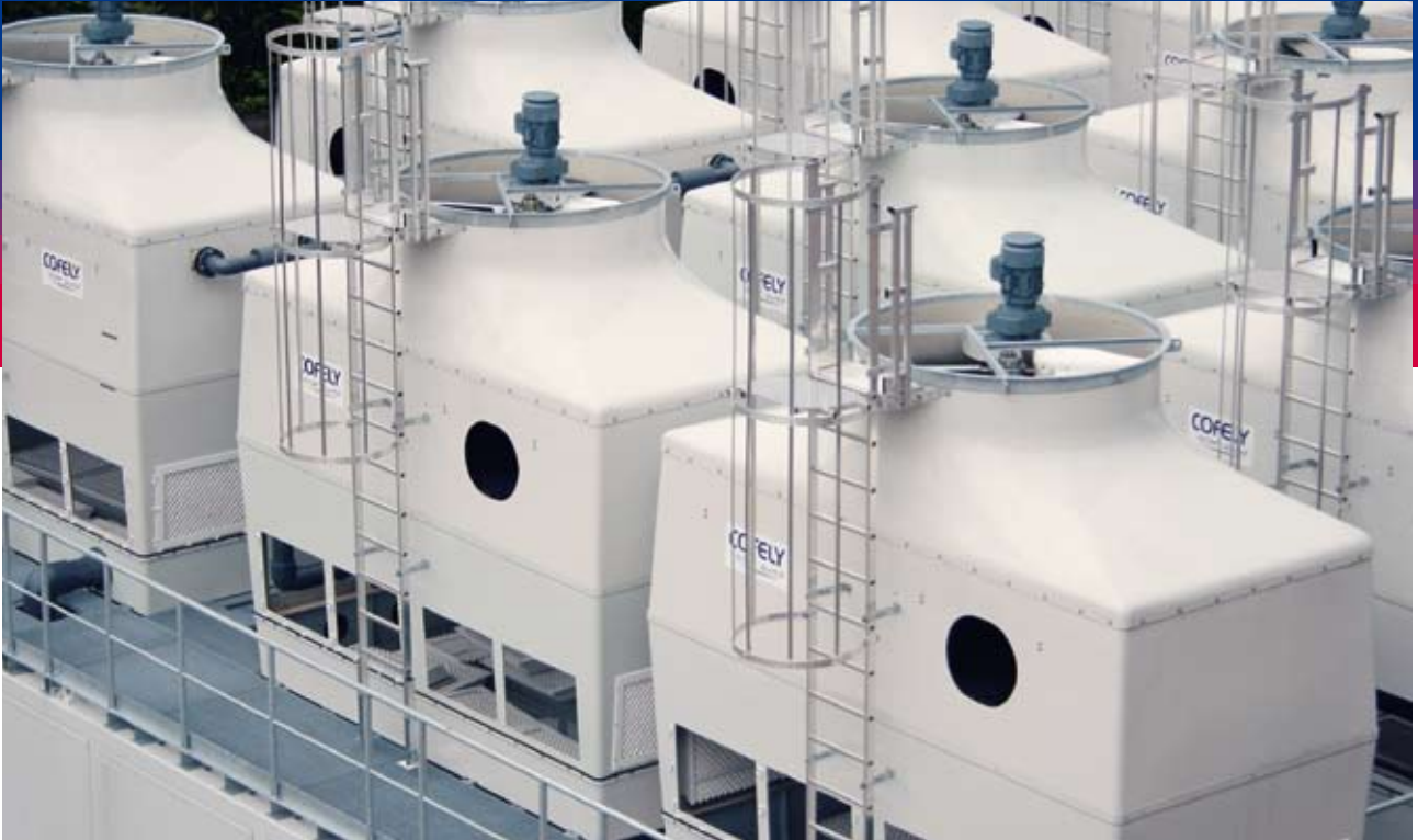
Kälteanlage für die Druckerei der Gulf News in Dubai.
